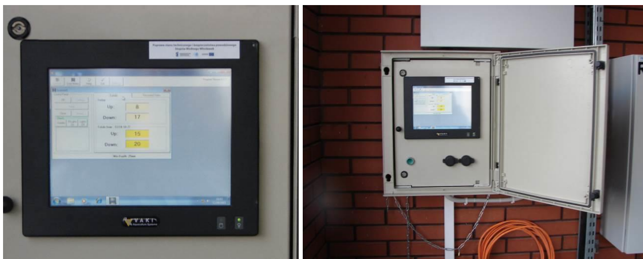
Fot. 8,9- Komputer obsługujący pracę skanera znajdujący się w budce sterowniczej jazu nr 10.
