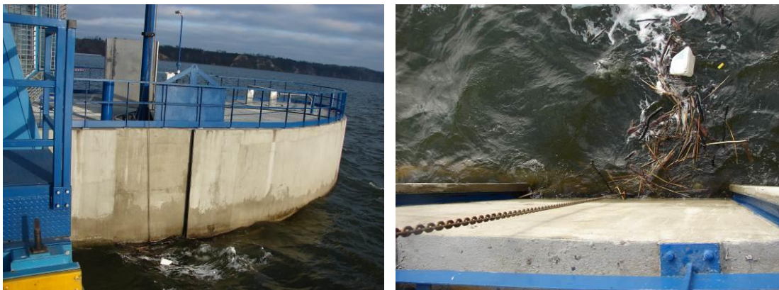
Fot. 5,6- Wlot wody do rurociągu wabiącego i kumulujące się przed nim zanieczyszczenia
