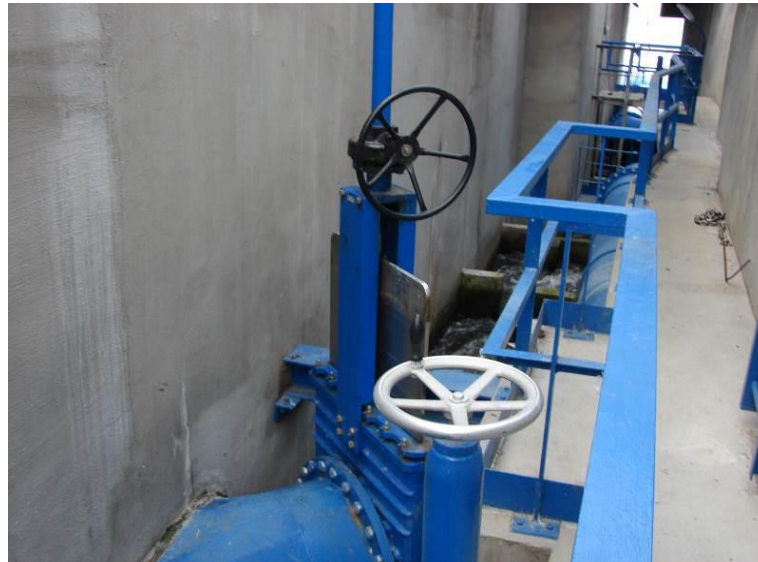
Fot.7- Zasuwa zamykająca rurociąg wabiący.
