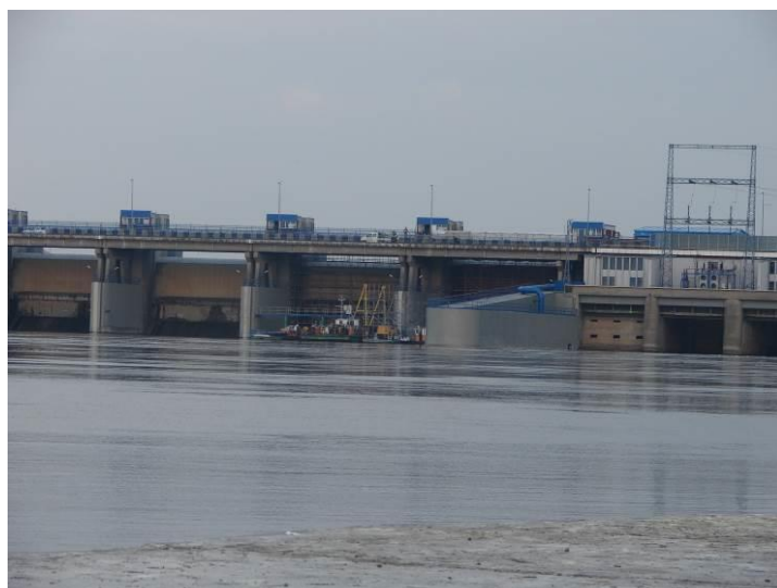
Fot. 25 - prowadzone prace pod jazem, tuż przy filarze przepławkowym, na wysokości zasuw nr 10.
